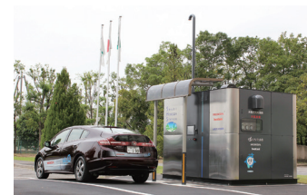
さいたま市 SHS実証試験
